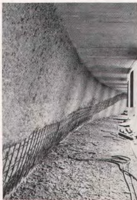
Fig. 44. Web spalling (courtesy of Clarence R. Yamamoto).
